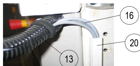
Rys. 15: Przewody do urządzeń peryferyjnych klienta w kanale kablowym
